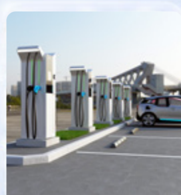
新能源充电站
