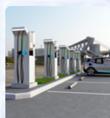
新能源充电站
