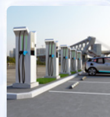
新能源充电站
